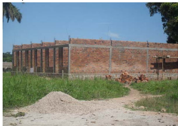
Une vue de la salle polyvalente en construction au chef lieu du territoire de Banalia
